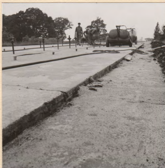
Pneumatisch gehobene Fahrbahnplatten
