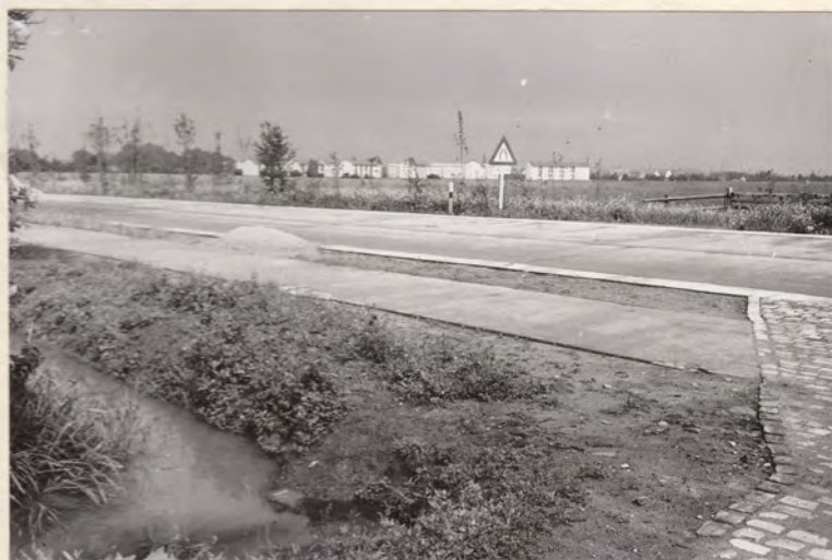
Rohrdurchlaß in der Stromer Landstr.
