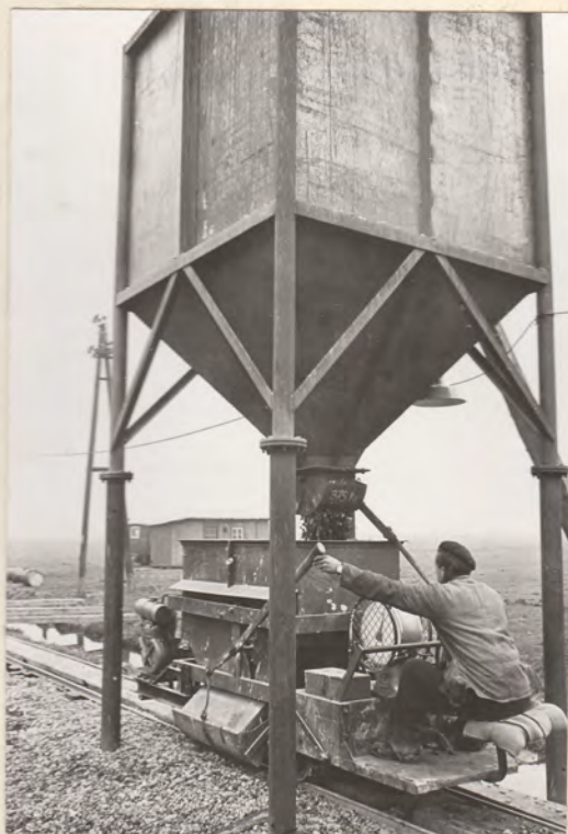
Zuschlagssilo mit selbstfahr. Lore und Wiegevorrichtung
